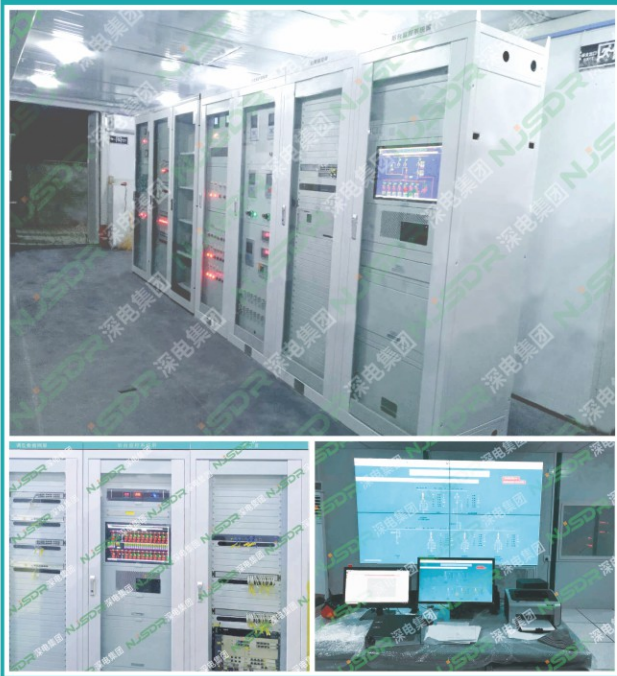
贵阳遵义城投大厦10KV配电室
