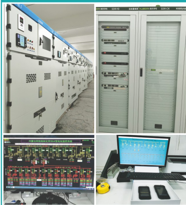
内蒙古同创高科化学有限责任公司同创35kV变电站工程
