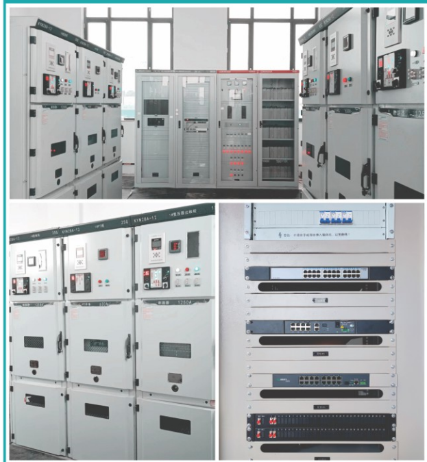
昌黎中关村生命园10kV配电微机后台通信屏现场
