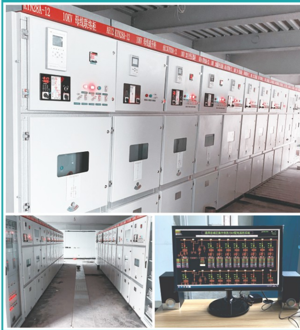
兰州通渭县城区集中供热10KV配电监控系统
