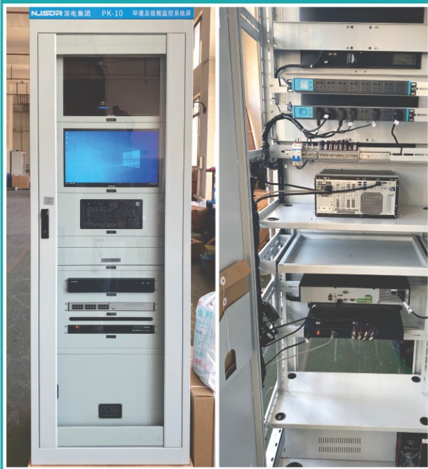
山东厚俞电气大捞坝预制舱智能辅助监控系统
