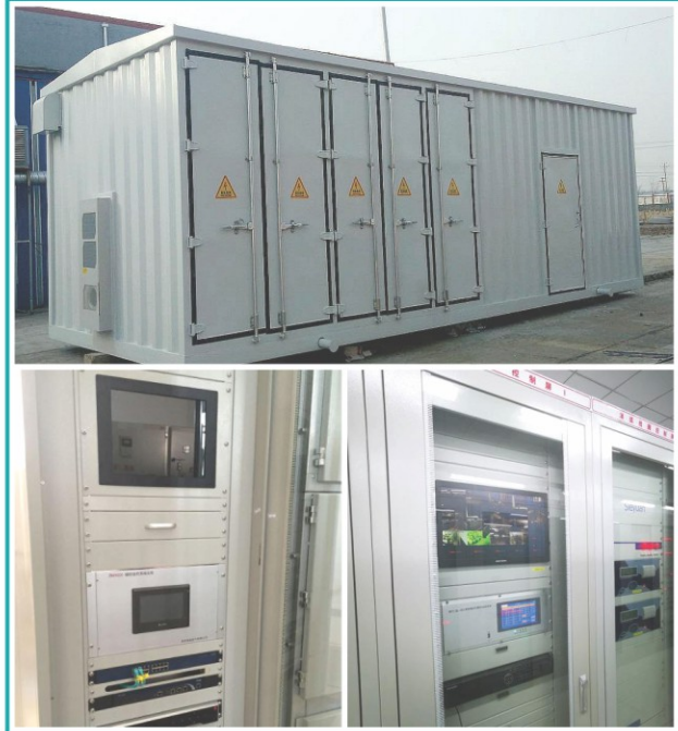
云南普恒煤矿有限公司35KV配电工程
