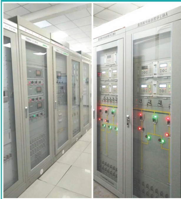
甘肃省张掖市山丹铁骑水泥110KV变电站
