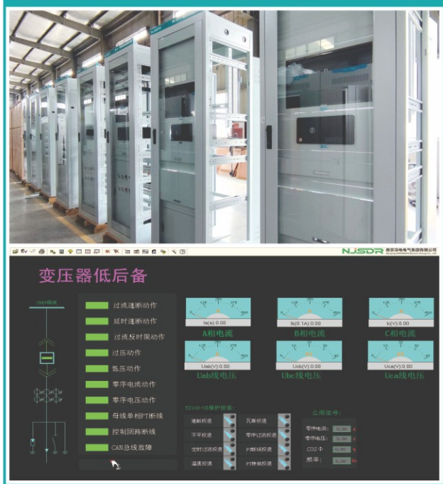
山西紫金矿业35KV变电所
