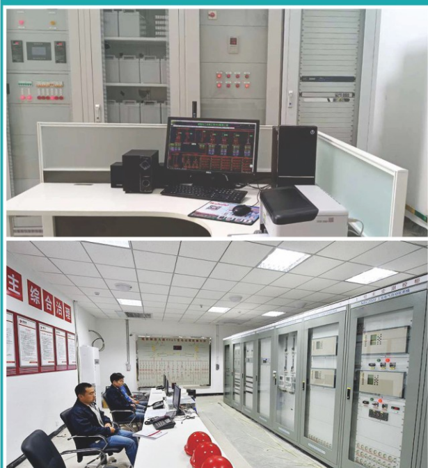
达旗污水净化10KV配电室
