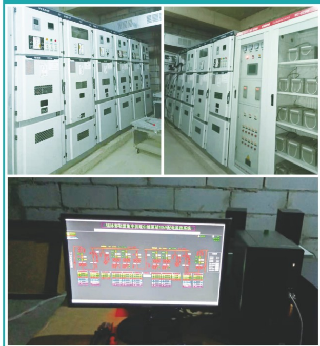
甘肃省张掖市山丹铁骑水泥10KV变电站
