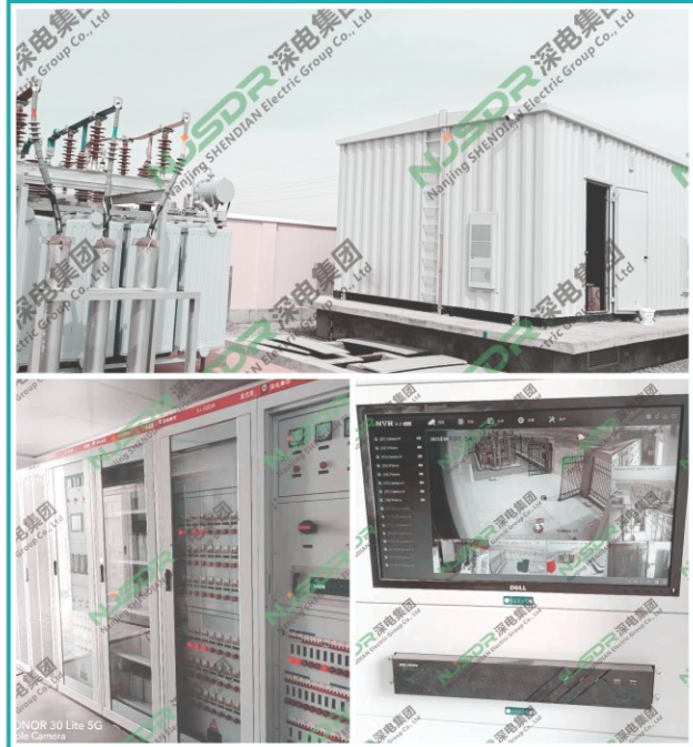
万家于田县华凌牛业35kV输变电工程
