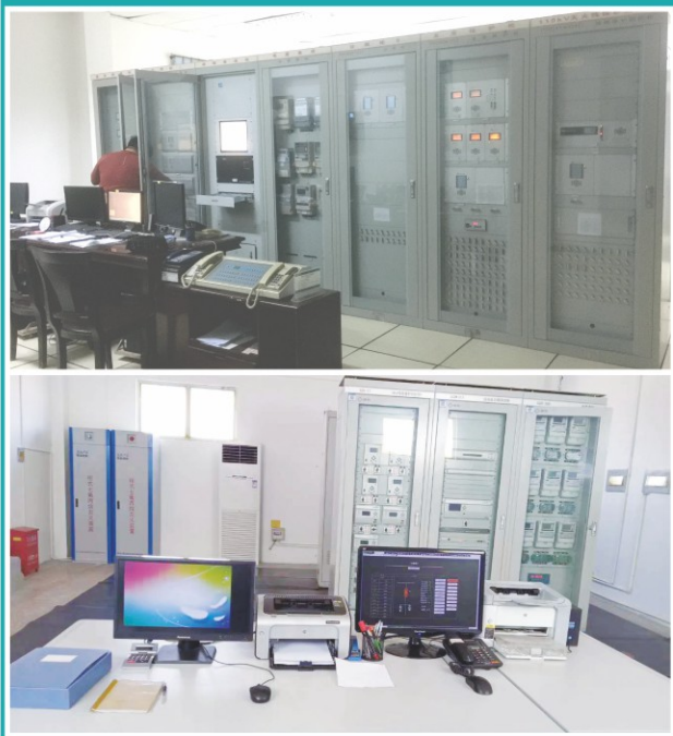
军留杨水站35KV工程
